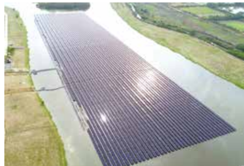
全國最大水域型浮動式太陽能發電系統位於台南的樹谷園區
