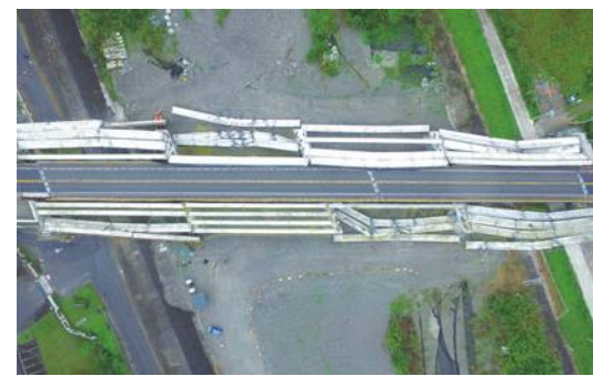
拓樞工事中だった橋の一部が崩落した(写真提供:中央社)
