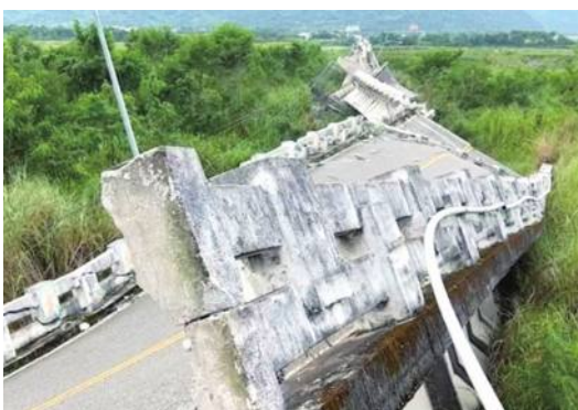
地震で崩落した花蓮県内の高寮大橋(写真提供：中央社) ンターの設置を指示し、引き続き地震を警戒しようと市民に呼び掛けている。
